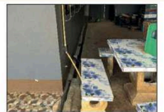
โครงสร้างเสริม เช่น ดาดฟ้าและลานบ้าน เอียงหรือเคลื่อนตัวออกจากตัวบ้านหลัก
